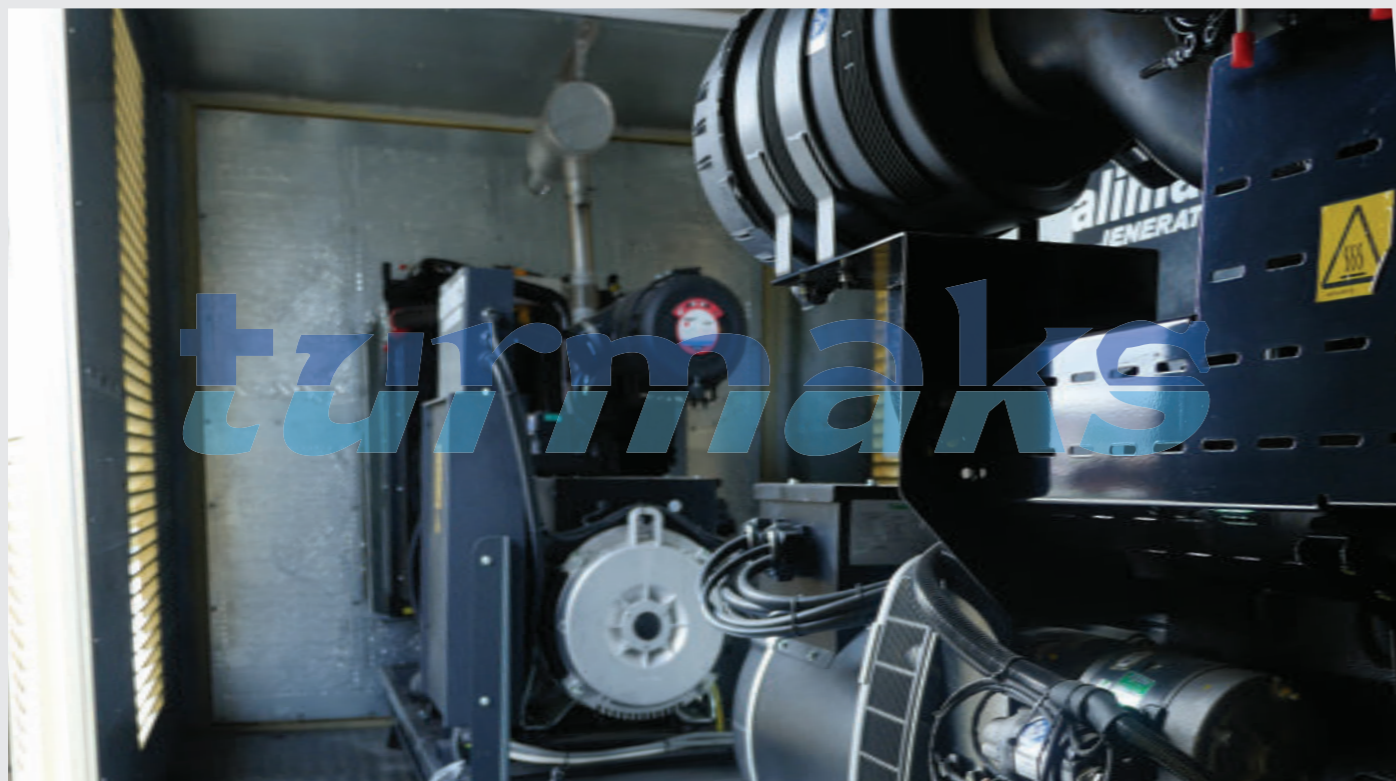
GRUPE ÉLECTROGÈNE AVEC SAUVEGARDE, CO-VIEILLISSEMENT ET SYNCHRONISATION
