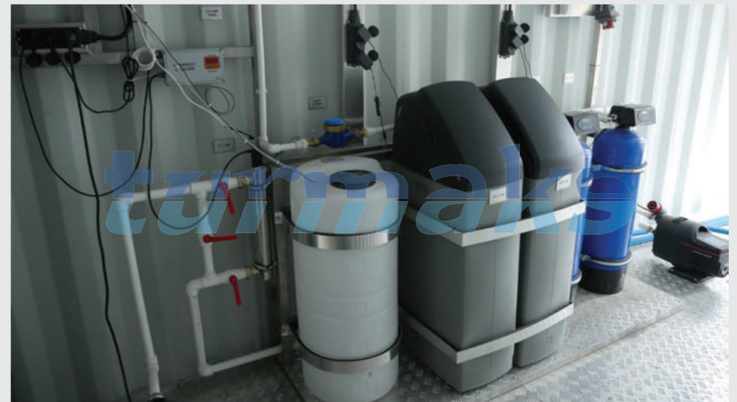
TRAITEMENT DE L'EAU
